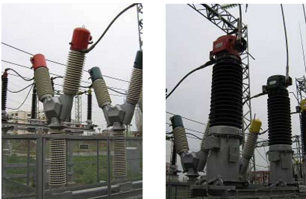
Снимка 7 Силови прекъсвачи и измерителни трансформатори
