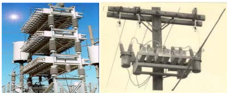
Снимка 5 Високоволтови кондензаторни батерии и измерителни трансформатори
