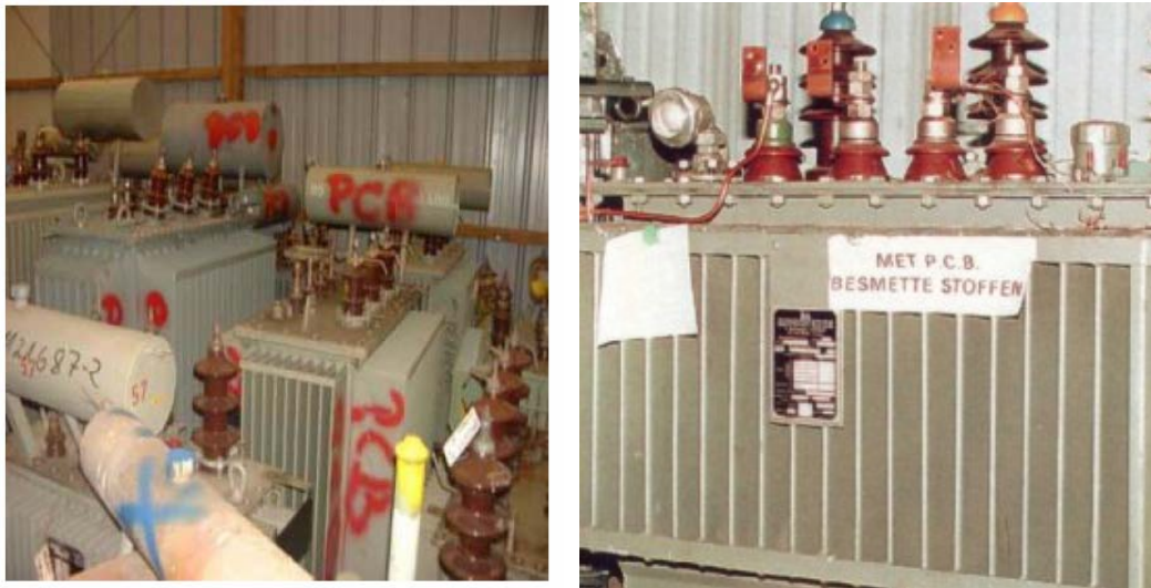
Снимка 11 Трансформатори и трансформаторни масла, съдържащи ПХБ
